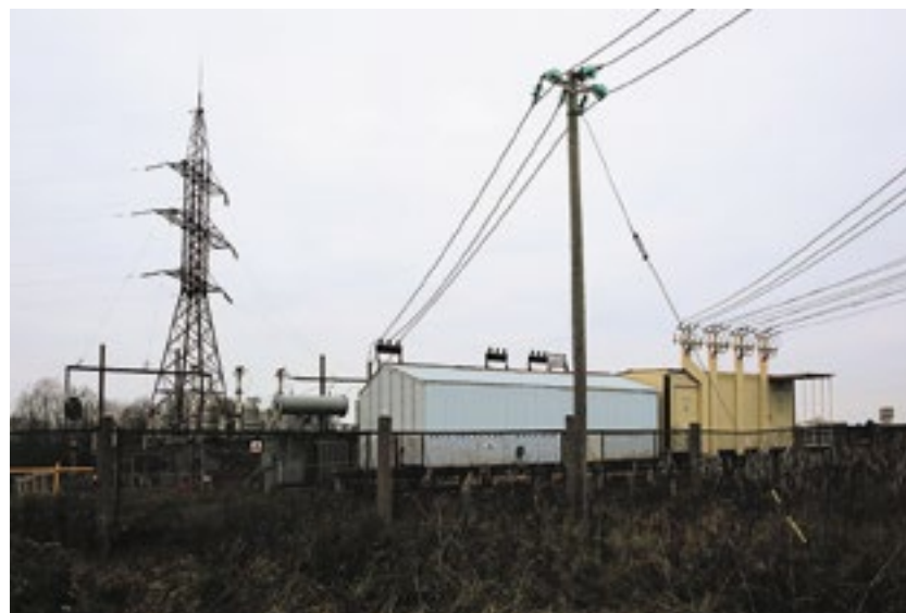
Специалисты «Россетей» участвовали в работах по реконструкции воздушных линий в зоне ответственности гатчинского филиала
