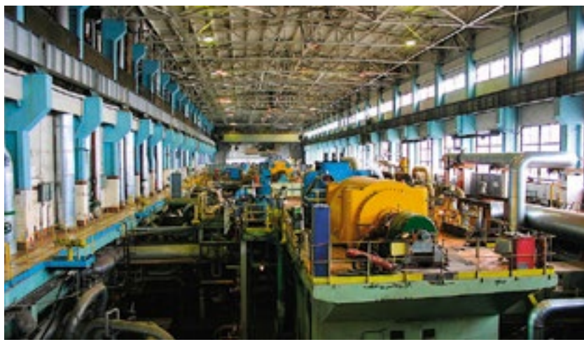
ЛАЭС является первой в стране станцией с реакторами РБМК-1000 (уран-графитовые ядерные реакторы канального типа на тепловых нейтронах)
