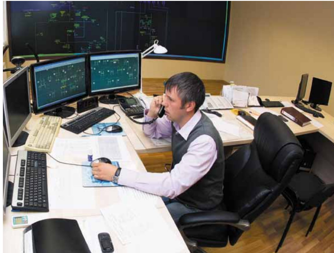
Алексей Тебряев, диспетчер филиала ОАО «Ленэнерго» «Новоладожские электрические сети», участвует в противоваварийной тренировке
