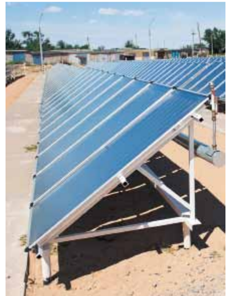
«Наримановская» солнечная электростанция позволит снабжать теплом и горячей водой около 13 тысяч жителей города Нариманов в Астраханской области, благодаря электроснабжению близлежащей тепловой станции
