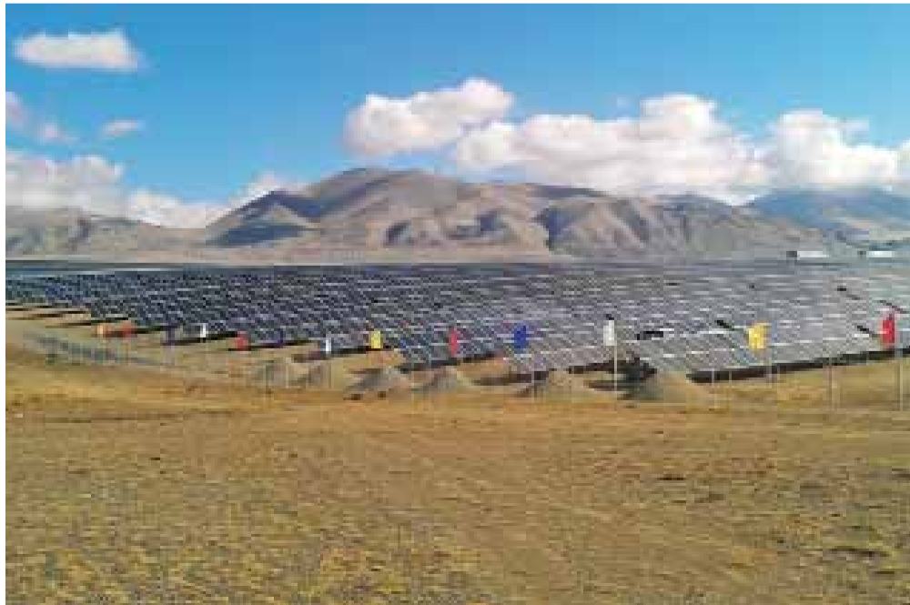
Солнечная электростанция в Алтайском селе Кош-Агач. Станция площадью около 13 гектаров, мощностью пять мегаватт запитает три муниципальных района с населением более 44 тысяч человек
